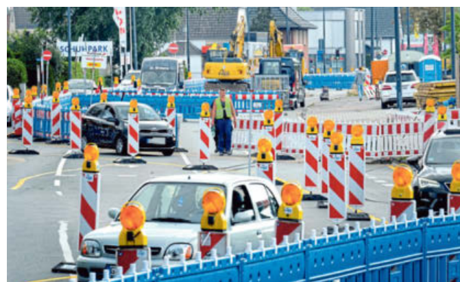
Mehr Sicherheit für die Arbeiter: Auch an der Baustelle Verler Straße wird der neue Arbeitsschutz berücksichtigt. FOTO: ANDREAS FRÜCHT
